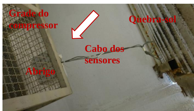
Figura 49 - Local da instalação dos sensores datalogger para coleta dos dados sem sombreamento, próximo a grade de um compressor de ar condicionado
