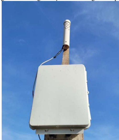
Figura 12 - Abrigo estação meteorológica completo
